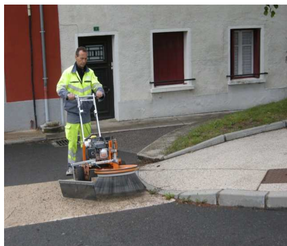
Utilisation de la brosse pour supprimer les herbes en bordure de trottoirs à Chamboeuf
