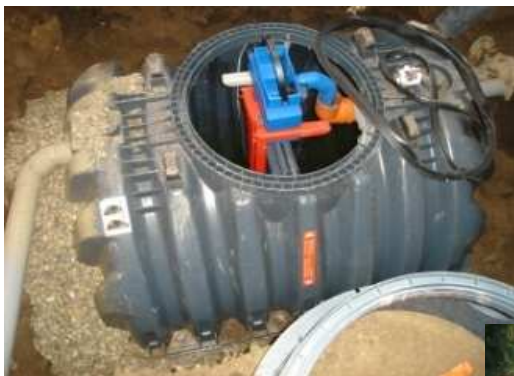
Micro station à Saint Martin en Haut
