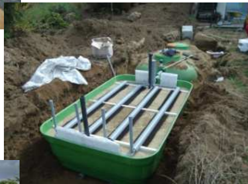
Filière compacte à zéolithe à Bellegarde en Forez
